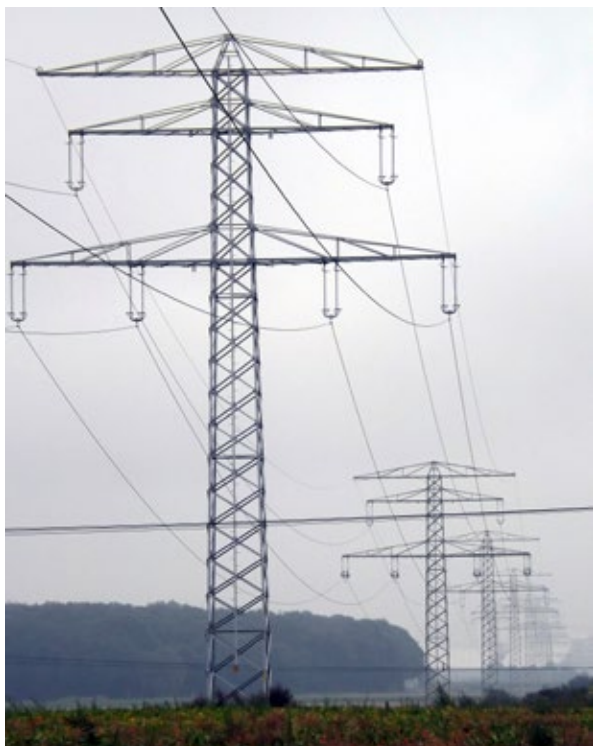
Für die Südlink-Gleichstromautobahn müssen drei von diesen großen Mastreihen nebeneinander aufgestellt werden, die zudem noch deutlich höher sind als diese Wechselstrommasten.
